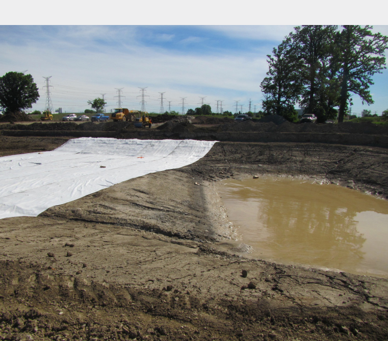
Un étang humide en cours de construction et aligné près de l'échangeur de l'autoroute 407 ETR.
