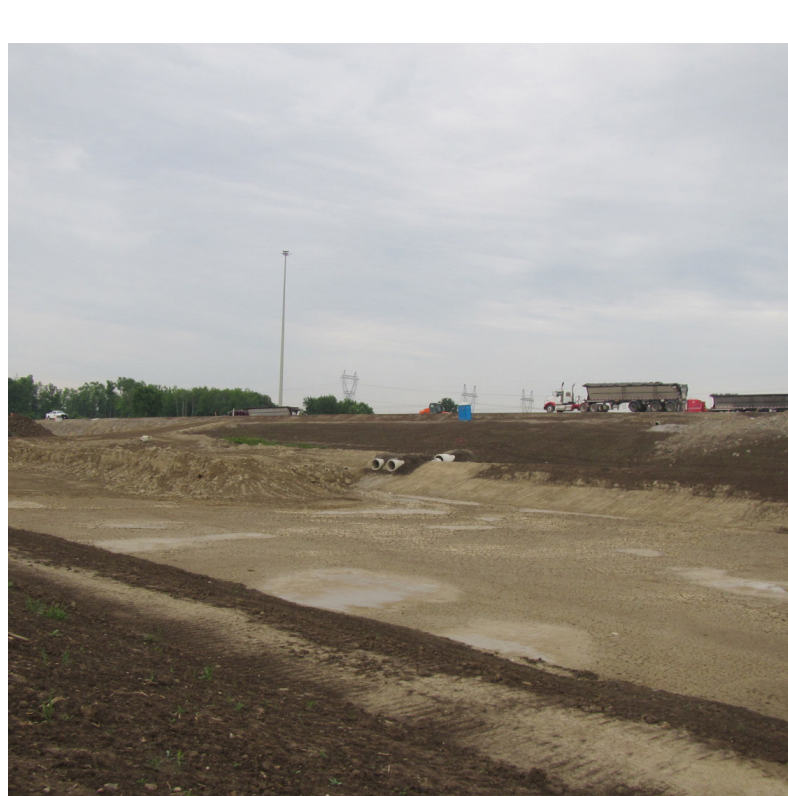
Un étang sec est en cours de construction le long de l'extension de l'autoroute 427 au sud du chemin Rutherford.
